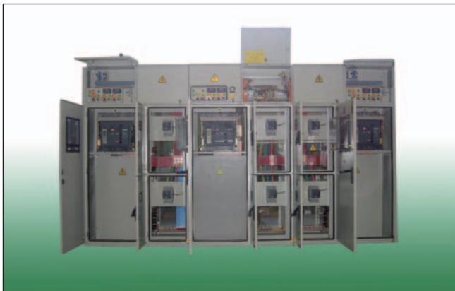
Комплектна двотрансформаторна підстанція 2КТПУ/ЕЛ-2500-6/0,4 УЗ
